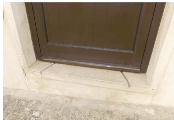
Fig. 7: Acanaladura en un umbral en una vivienda de construcción tradicional de Portugal
