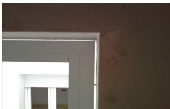
Fig. 2: Holgura excesiva entre ventana y perímetro de fábrica
