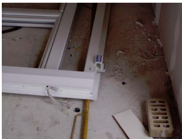
Fig. 9: Ventana mal acopiada y situada en el suelo sin cuidado, antes del proceso de su fijación en la fábrica de fachada.
